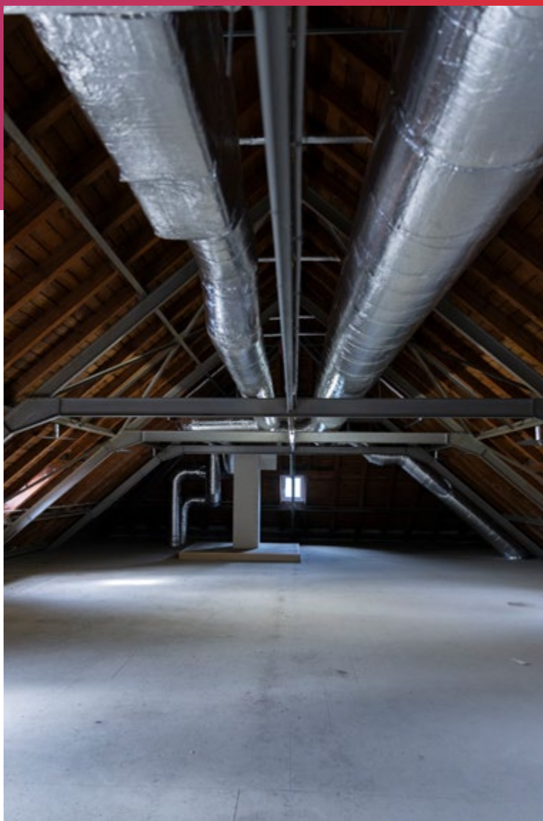
Abb. 3 u. Abb. 4: Die Anlagentechnik im Hessischen Staatsarchiv Marburg
